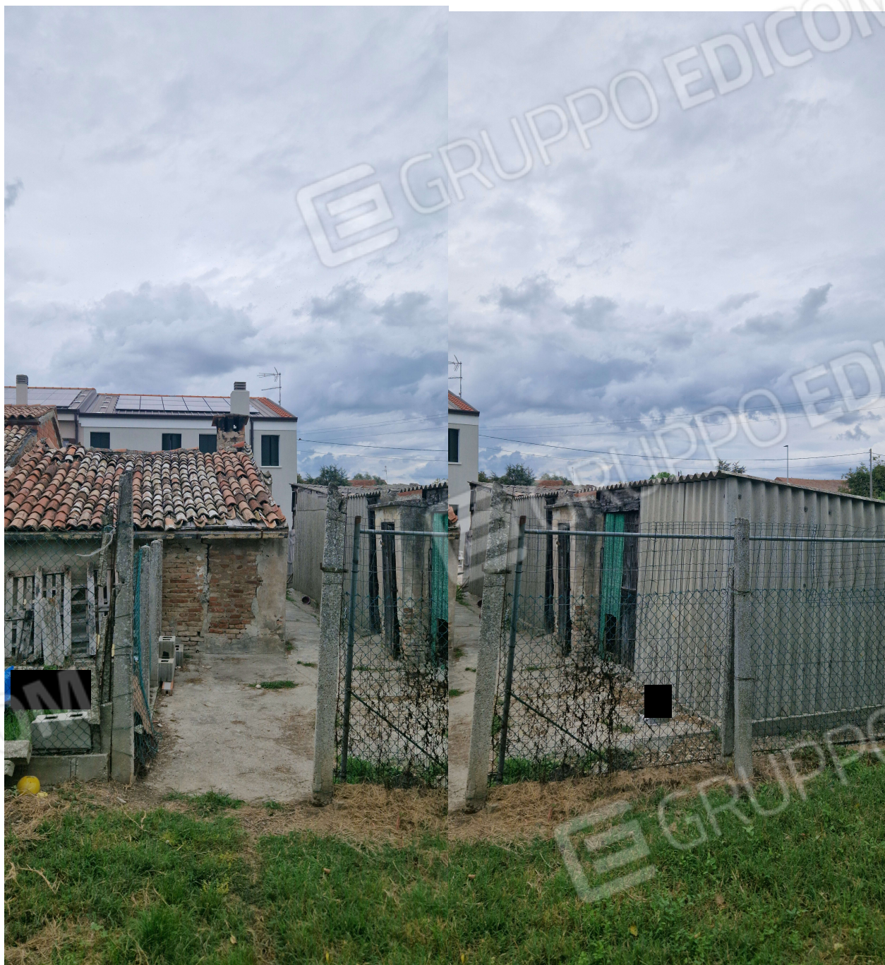
Particolare con possibile amianto
