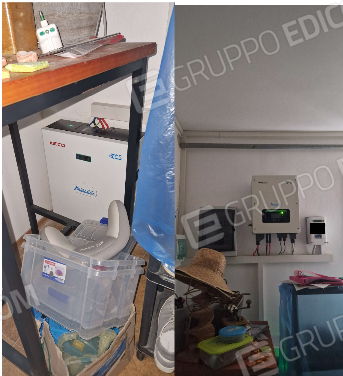
Inverter e batterie del fotovoltaico
