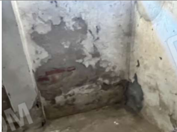
Vista interna – Infiltrazioni parete perimetrale esterna
