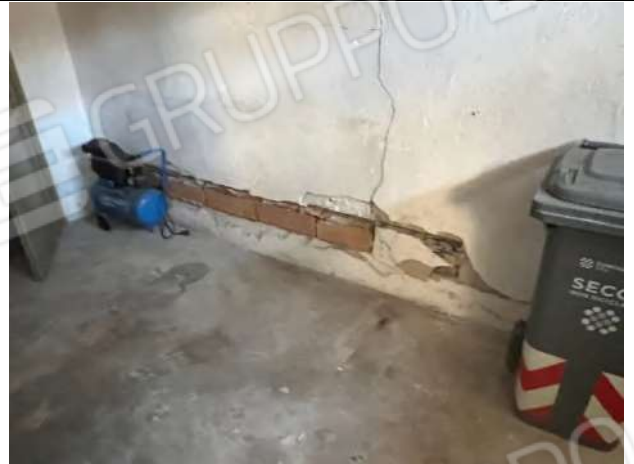
Vista interna – Deterioramenti parete perimetrale interna verso altra unità
