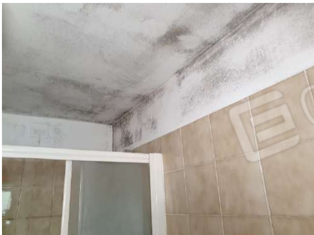
foto n. 7 – particolare soffitto bagno al P.T con muffe
