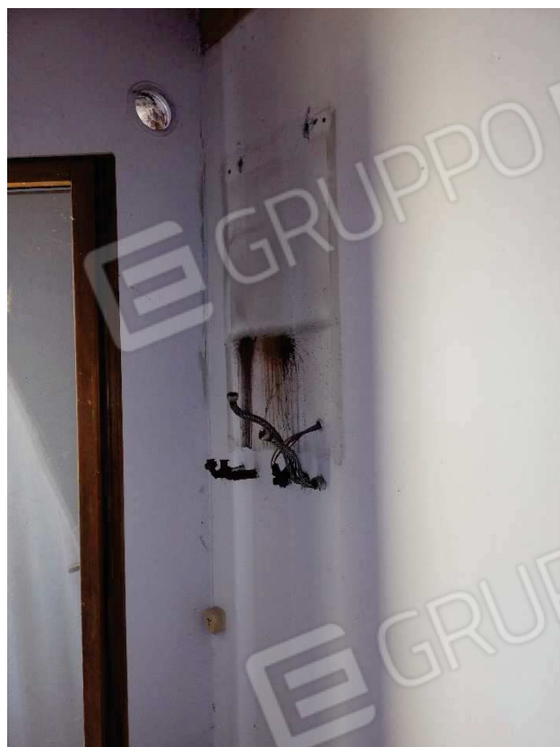
Foto 14. Partic. Attacco caldaia
