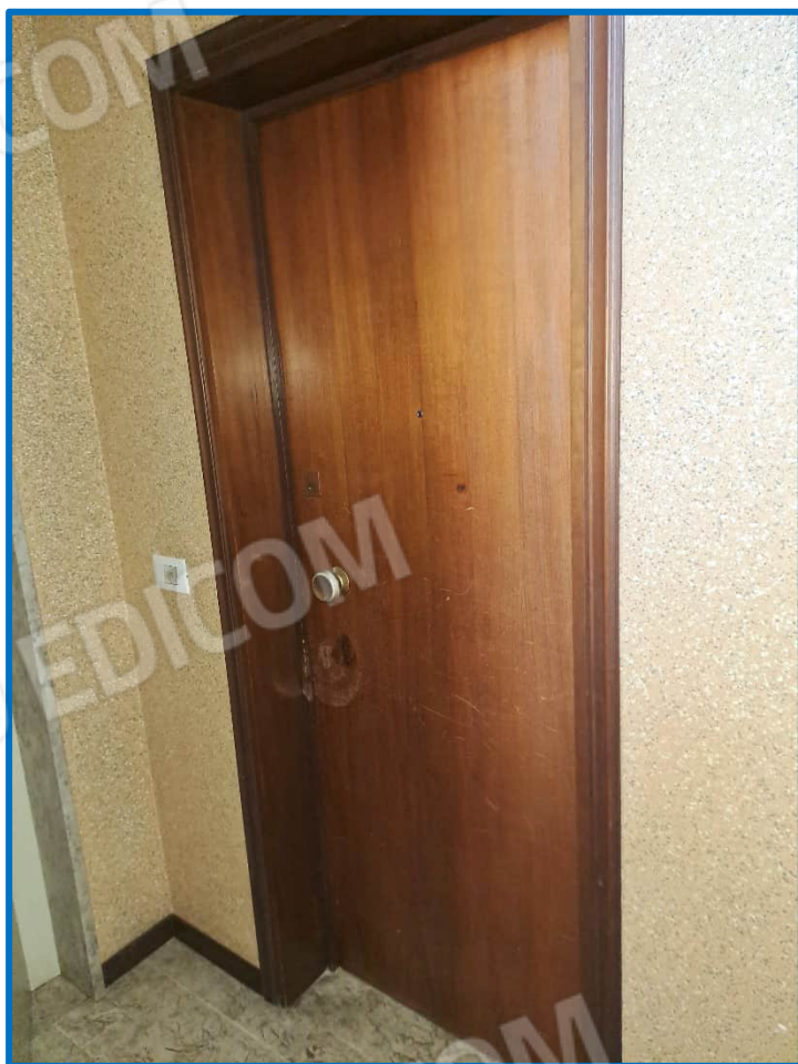
n° 4 Portoncino d'ingresso alloggio
