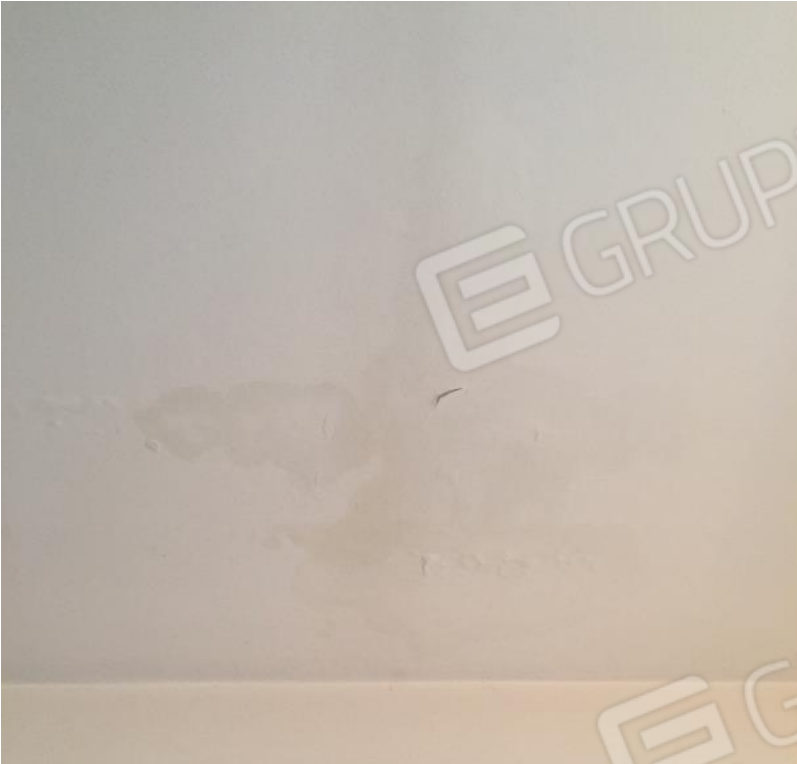
Ingresso primo piano - infiltrazione
