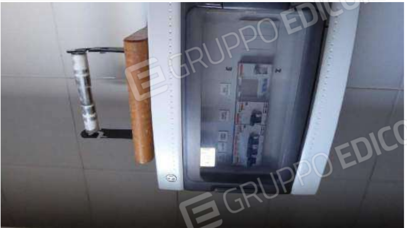
Foto n. 21 – vista quadro generale elettrico
