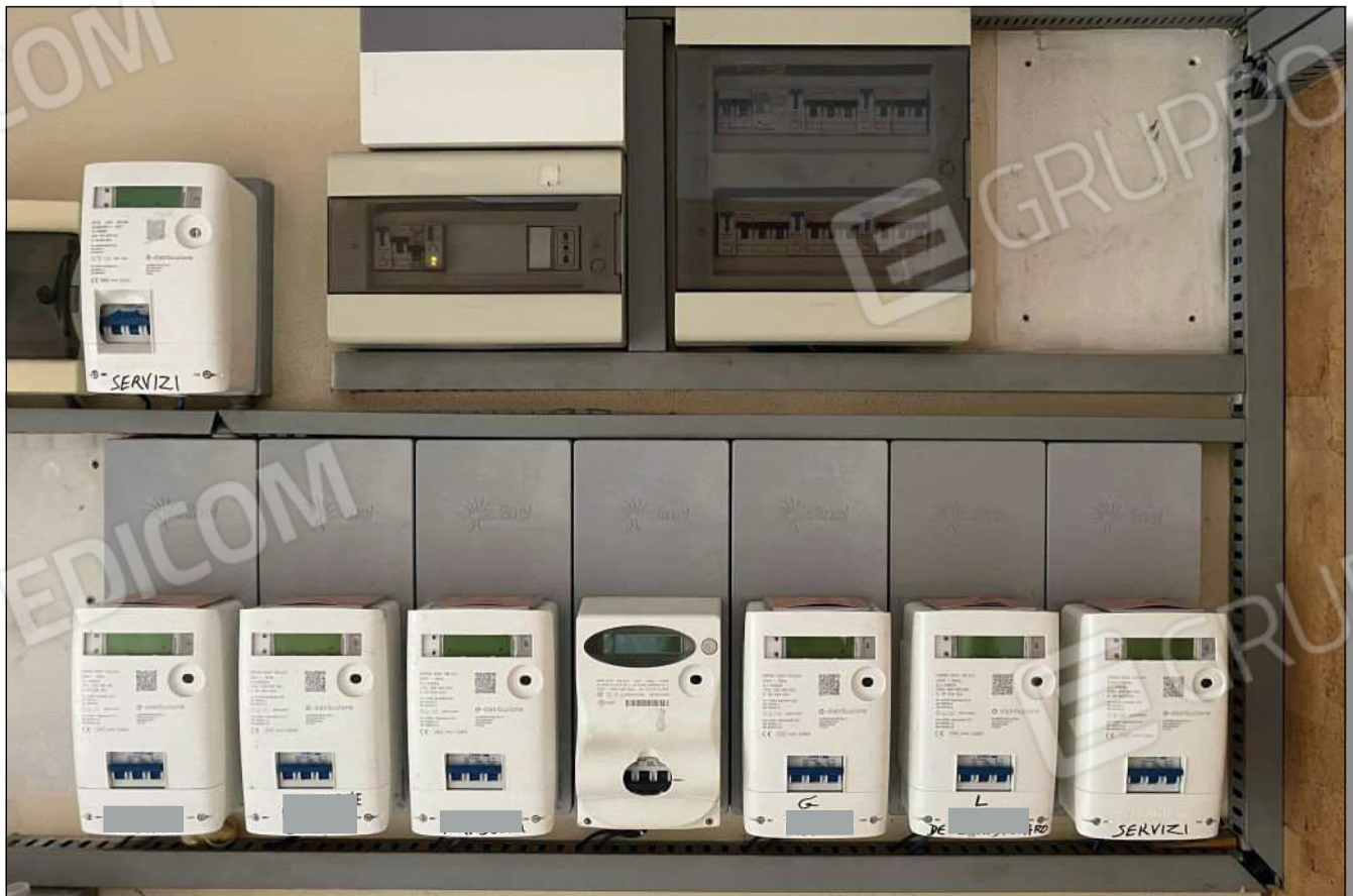
Foto n. 20) Vista dei contatori Enel
