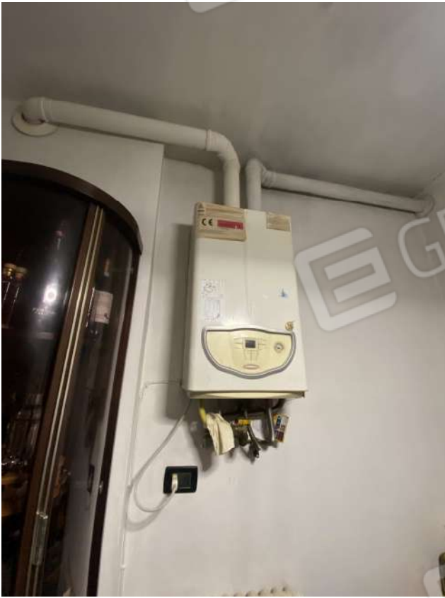
FOTO 13: Caldaia ubicata in cucina
