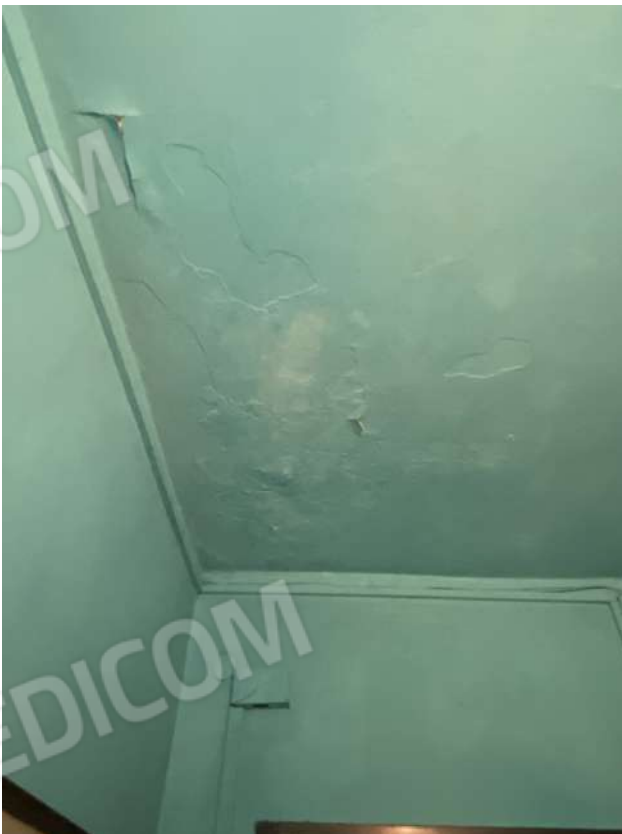
FOTO 8: Evidenti problemi di infiltrazioni/umidità
