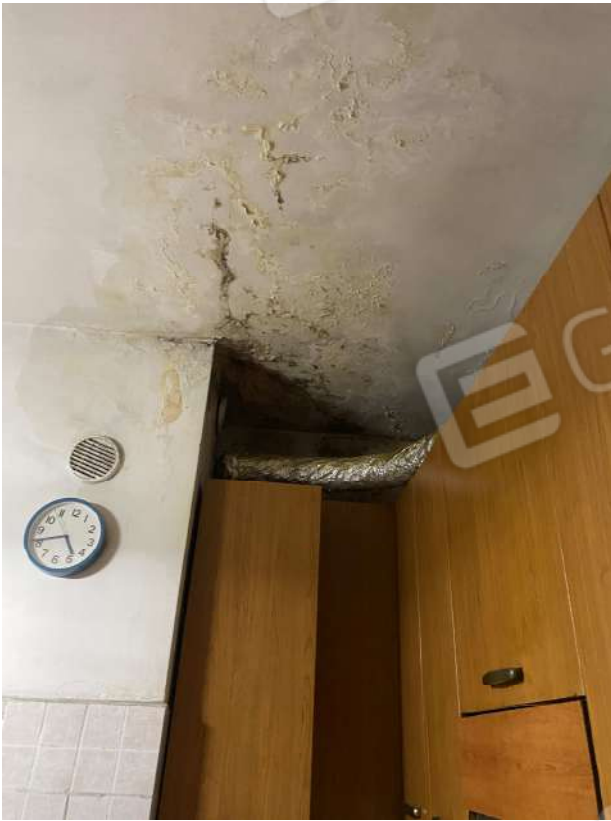
FOTO 15: Infiltrazioni e muffa in cucina
