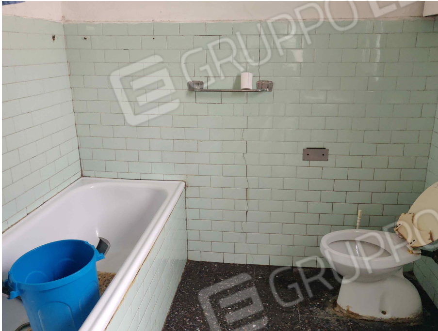
foto 11: bagno p.1 corpo A - abitazione
