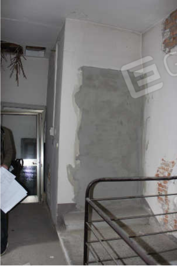
38 porta comunicante con terrazzo chiesa murata
