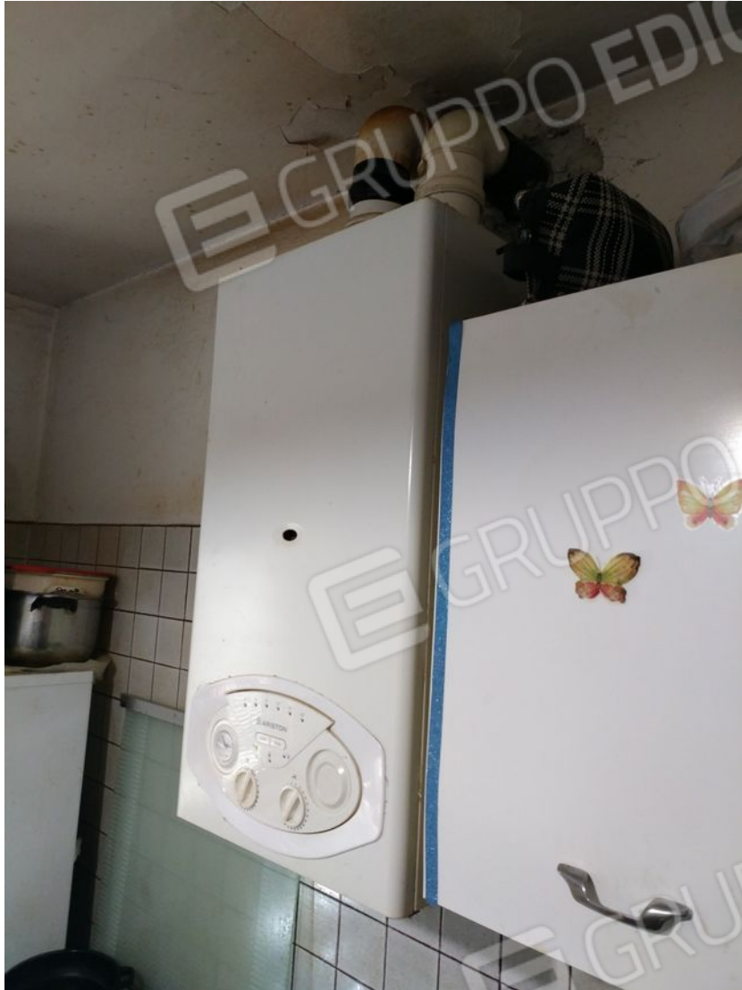
Foto 20 Vista della caldaia.
