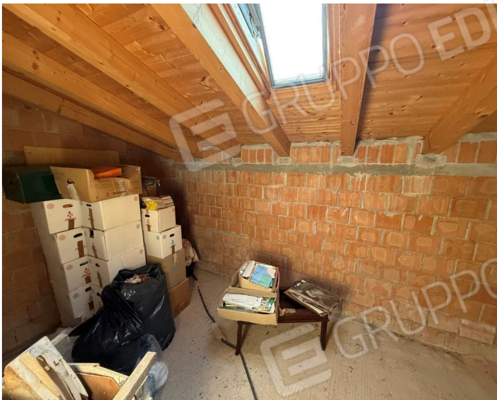
Foto n°13: vano guardaroba da completare.
