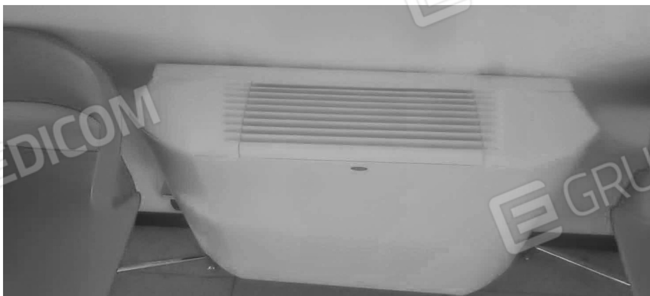
Foto n. 19 Diffusore aria fredda/calda - particolare
