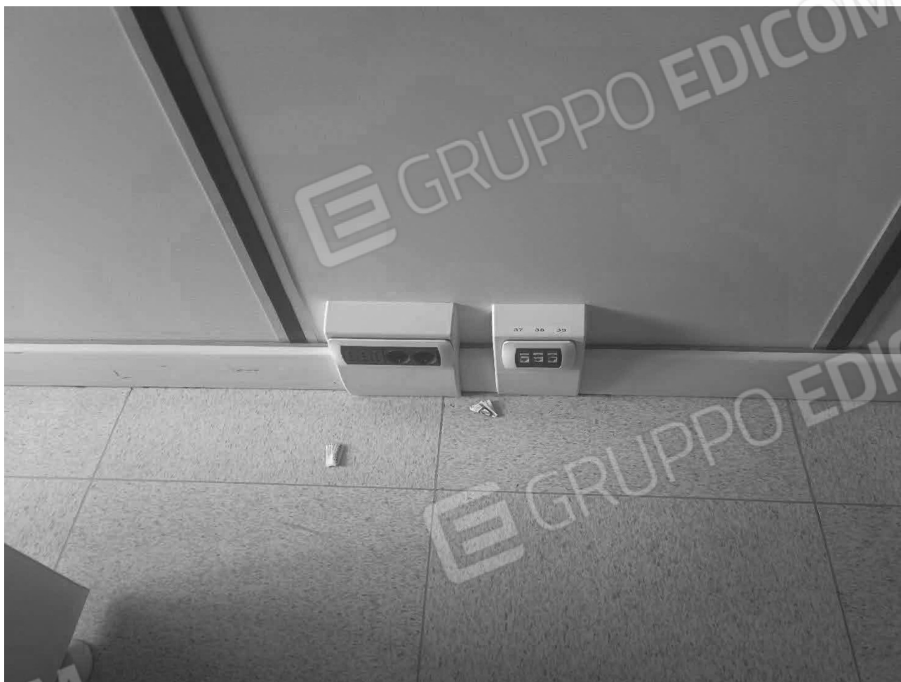
Foto n. 18 Impianto elettrico - particolare
