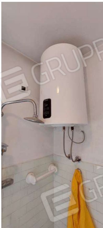
BOILER PRODUZIONE ACQUA SANITARIA
