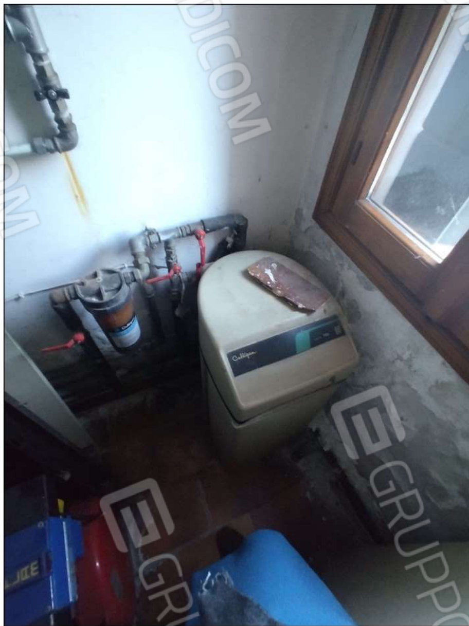
foto 28 -centrale termica comune
