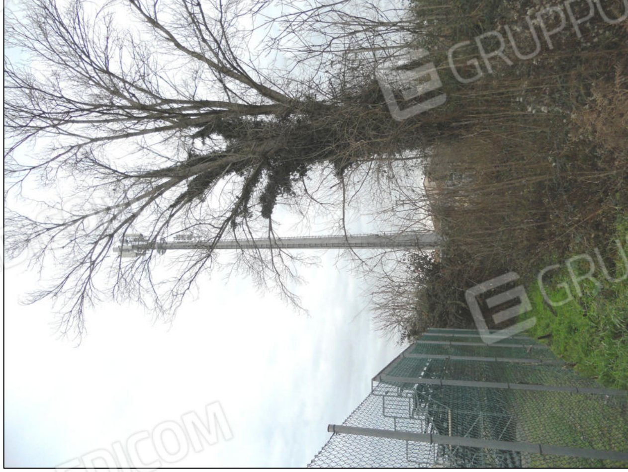
FOTO N°3 - VISTA DELLA STAZIONE RADIO PER TELECOMUNICAZIONI
