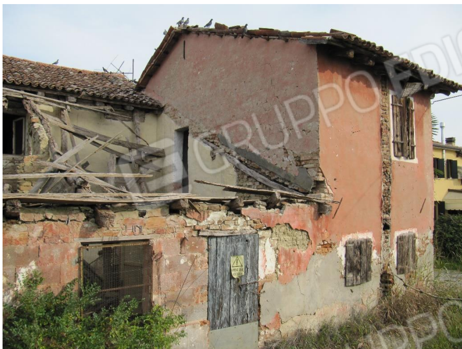
Particolare con edificio mappale 1013 in rovina addossato al fabbricato del mappale 1155
