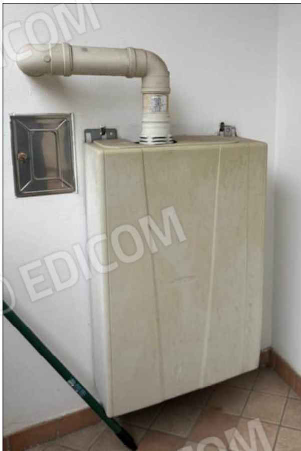
Foto n. 32) Vista della caldaia
