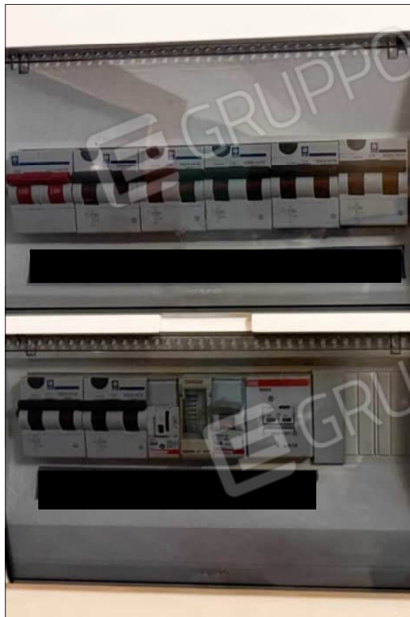
Foto n. 33) Vista dei magnetotermici
