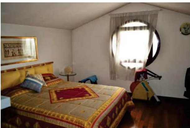
foto 3 - scorcio interno della stanza da letto a piano 13° sottotetto sommitale dell'appartamento m.n. 1970 sub 69 con la finestra rotonda rivolta verso est e con segni di condensa sui paramenti esterni e sul soffitto all'interno del locale.
