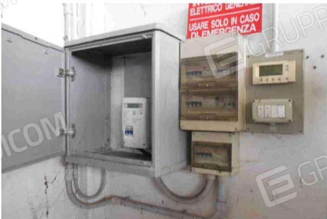
Contatore e quadro elettrico
