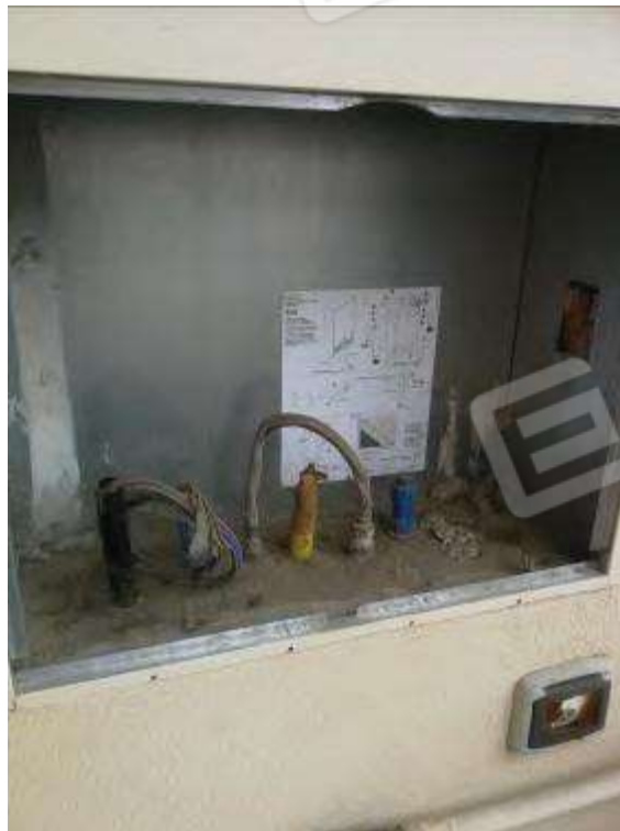
PREDISPOSIZIONE PER INSTALLAZIONE CALDAIA
