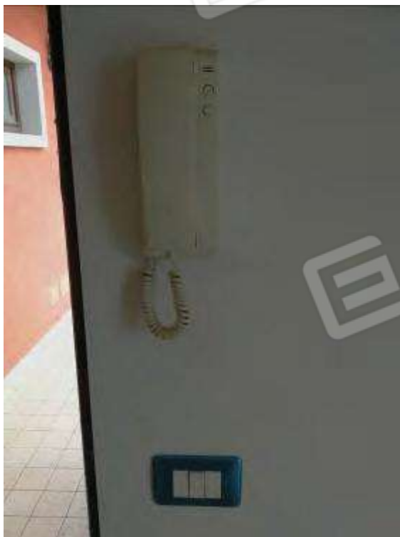
CITOFONO E PLCHE CON PELLICOLE DI PROTEZIONE
