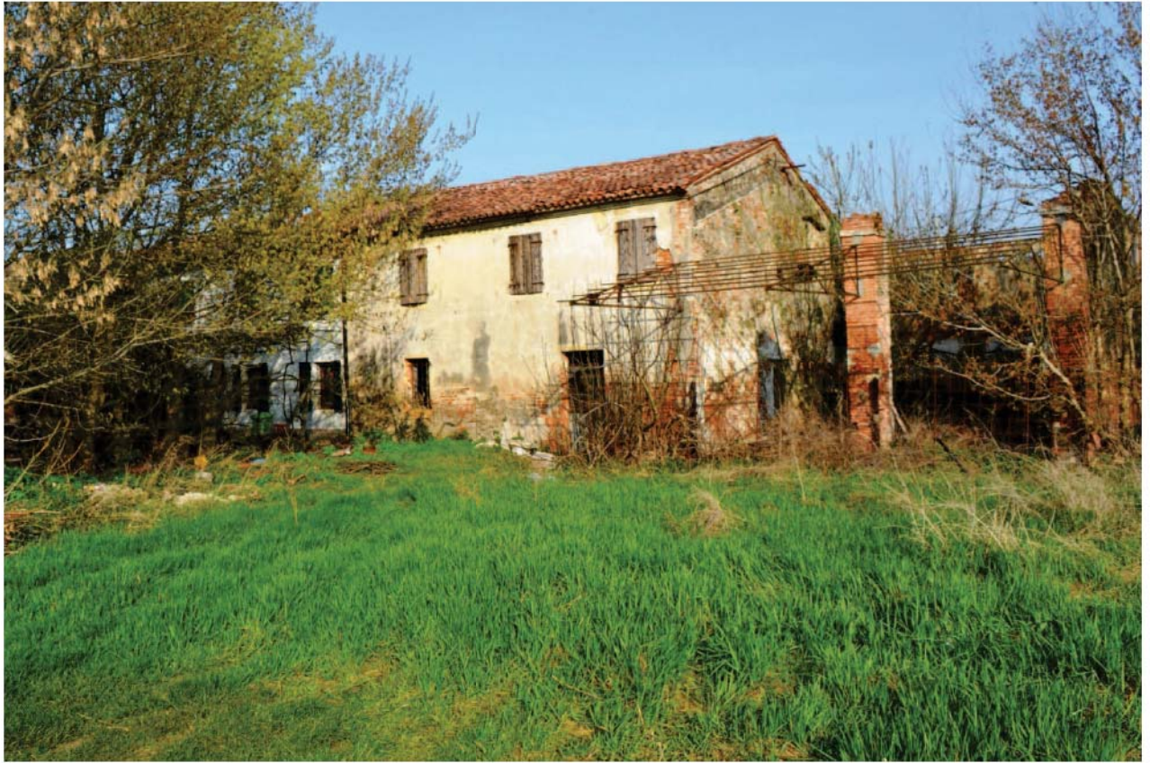
foto 11 – Prospetto sud (visto da sud est) dell’abitazione a sud di via Castelletto - parte della schiera al centro della foto, tra il tubo di gronda e il rudere senza copertura, distinta al fg. 11, m.n. 261 sub 1 del CEU di ERBÉ e costituente parte del Lotto n. 3 della CTU.
