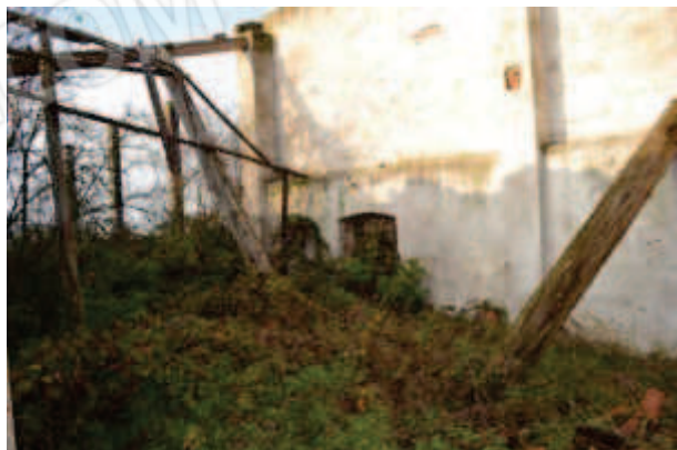
foto 19 – Vista del portico col soffitto collassato
