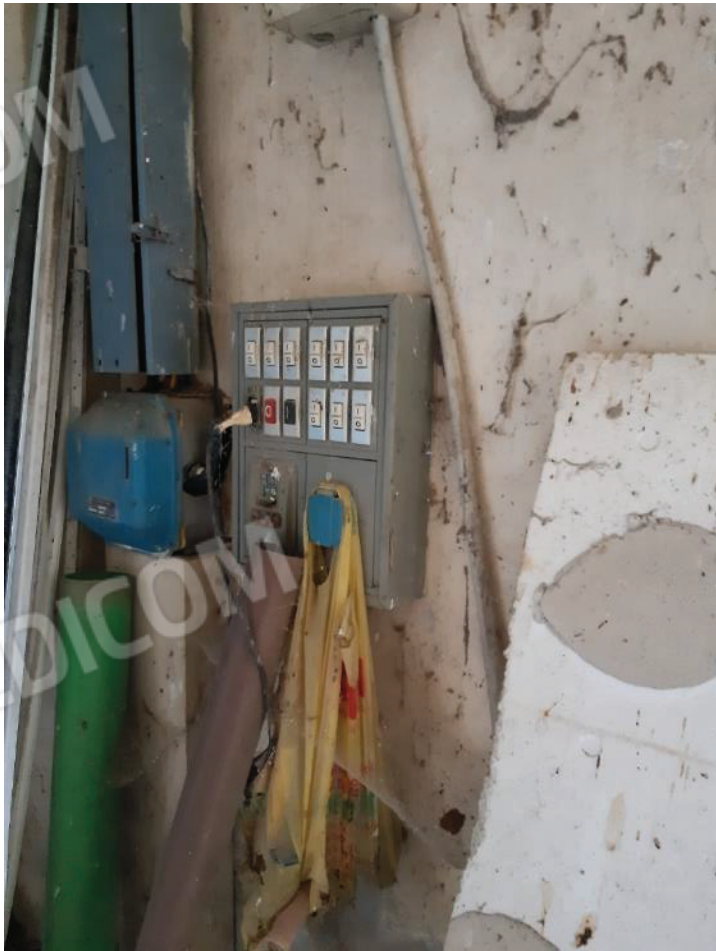
particolare quadro elettrico non funzionante.
