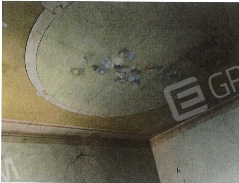
18. Camera con affaccio su via Vittorio Emanuele: soffitto ammalorato - p.1 (fg 8. Mapp. 323 sub 1)
