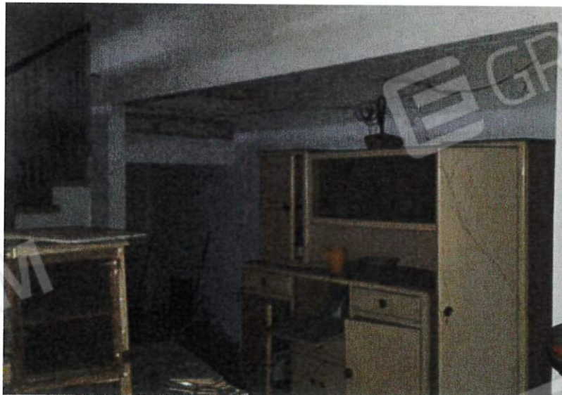
12. Locale secchiaio con scala di collegamento al piano primo - p.t. (fg 8. Mapp. 323 sub 1)
