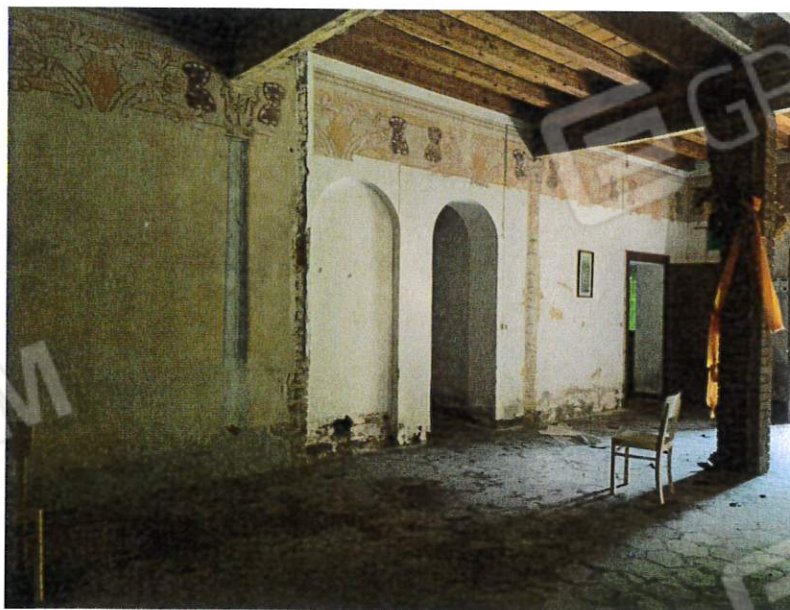
10. Locale sala in cui è stato demolito il divisorio tra le due unità - p.t. (fg 8. Mapp. 323 sub 1)
