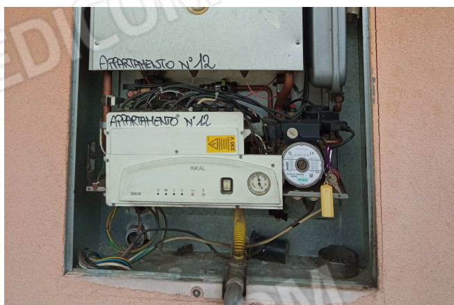
foto 15 - Particolare della caldaia murale sul balcone
