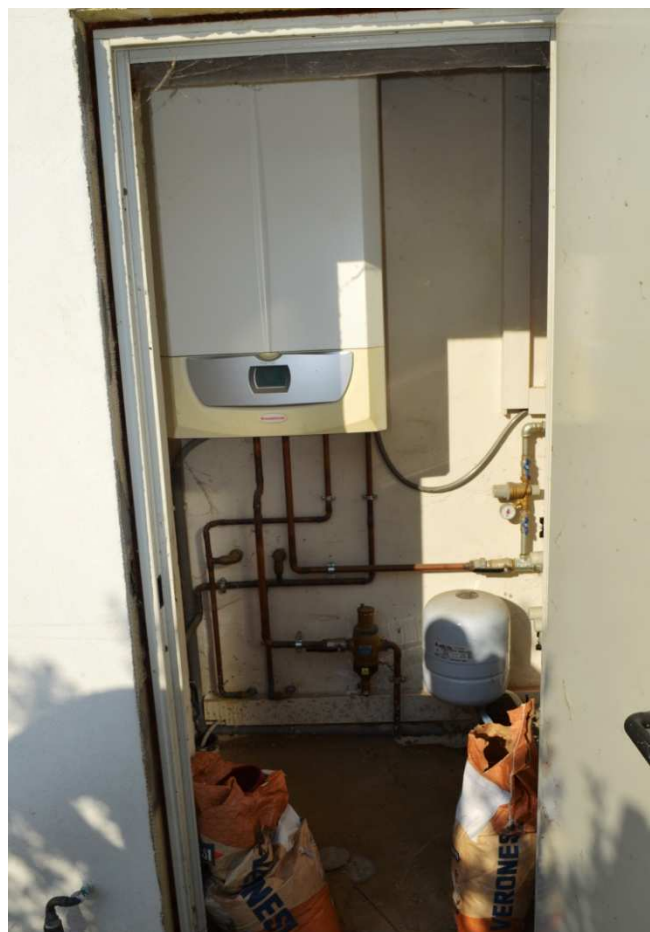
foto 22 - Locale centrale termica con porta esterna
