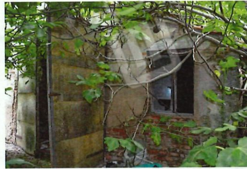
foto 8 - m.n. 316 (sub2) - L'annesso posto auto è anch'esso in pessimo stato di conservazione.
