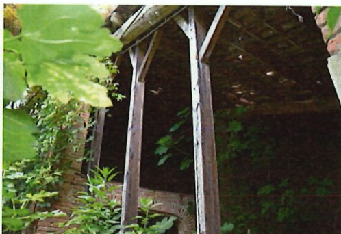
foto 18 - m.n. 316 (sub1) - L'ordito di copertura del fienile è dissestato e pieno di buchi.
