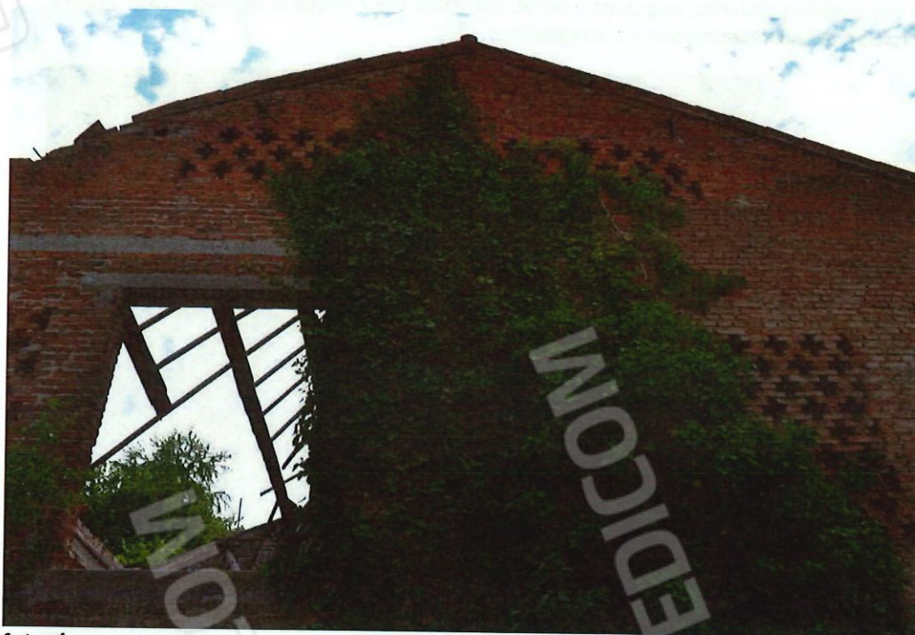
foto 4 – m.n. 316 (sub 1 visto ovest) – Come si vede anche dall'aerofoto satellitare, un'estesa porzione della falda di copertura nord è crollata. Il fatto risale a epoca non meglio precisata. Tutta questa parete, oltre a denunciare già a vista una scarsa qualità muraria, dovuta anche dal deterioramento dei laterizi per la prolungatissima esposizione diretta alle intemperie, è invasa dall'edera rampicante.
