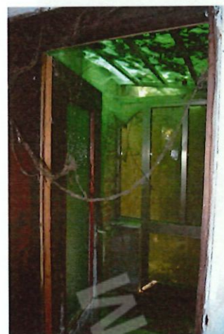
foto 16 - sub 3 (veranda) – Gli infissi sono chiodati sopra un muretto di base. Telaio e vetri hanno scarsa o nulla prestazione termica, oltre a presentarsi semi-distrutti e invasi di vegetazione.
