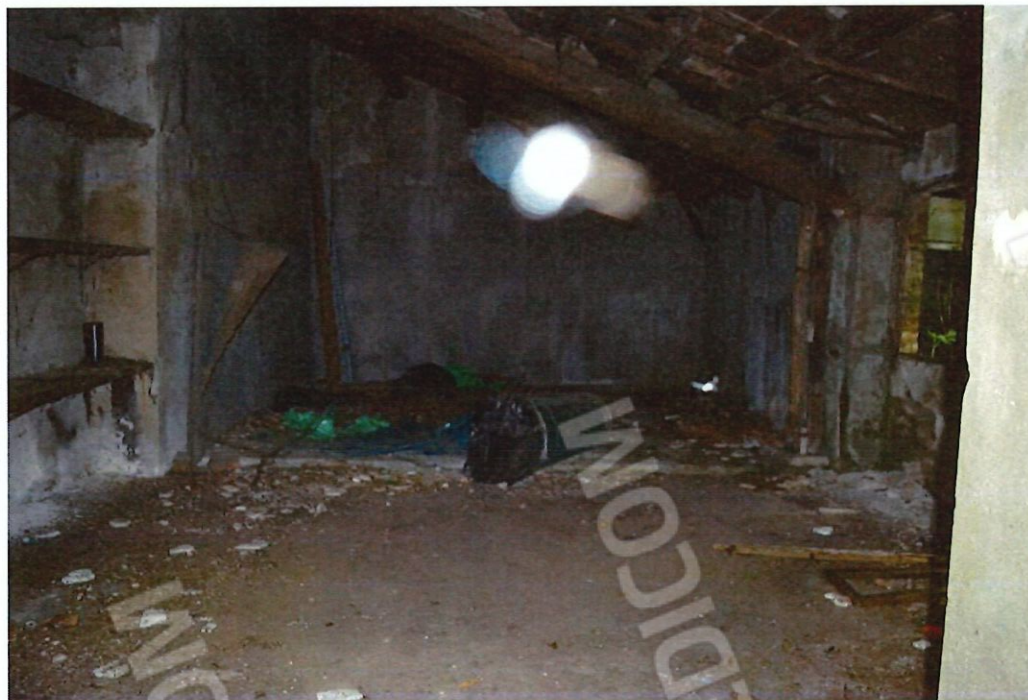
foto 25 – m.n. 316 sub 2 (garage) – Il posto auto tra il ripostiglio esterno e il ricovero attrezzi/magazzino/fienile è immerso in una fittissima vegetazione, ha i muri saturi di umidità e regge una copertura bifalda con l'ordito imbarcato e privo di qualsivoglia coesione o caratterizzabilità. Tutti i paramenti murari degli accessori, per come si presentano, difficilmente possono raggiungere anche solo meccanismi locali di primo modo. "Conformità statica" difficile se non impossibile da certificare.
