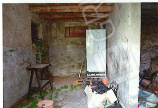
foto 14 - sub 1 (magazzino) – Alle due cantine rivolte verso il giardino fronte strada si accede da un ingresso autonomo. I vani sono tenuti al rustico. Porta apribile con qualche strattone. Locali giocoforza accessori e non abitabili.
