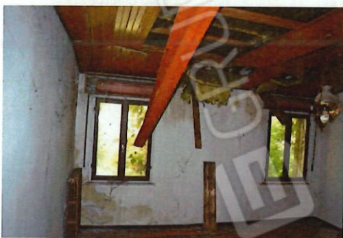
foto 21 - sub 3 (letto) – Il crollo del controsoffitto in perlinato scopre l'ordito di copertura.
