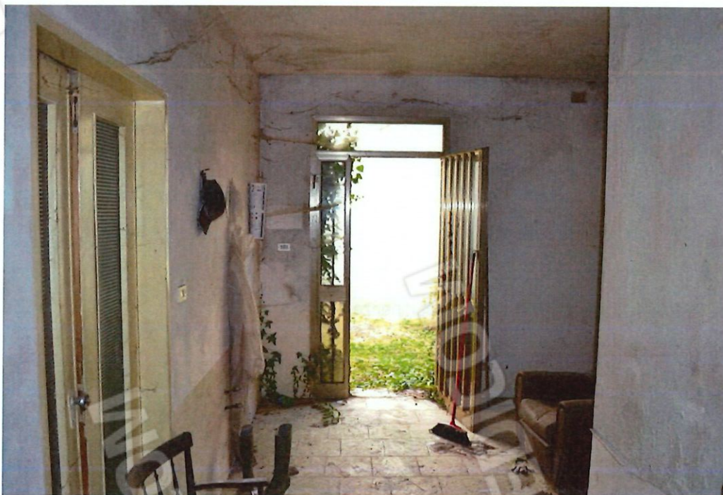
foto 2 – m.n. 316 sub 1 ("ripostiglio") – Tutto il lotto edificato è abbandonato da lustri. Forse vi fu qualche modesto intervento di pulizia e di sistemazione col passaggio di proprietà successivo alle precedenti esecuzioni forzate che lo colpirono (RGE n. 184/2004 tribunale di Verona, poi riunita alla n. 42/2008), ma allo stato attuale finiture e impianti sono da considerarsi totalmente compromessi.
