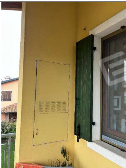
Caldaia in terrazza
