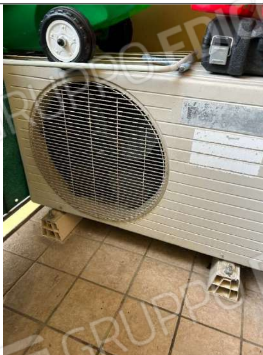
Condizionatore in poggolo
