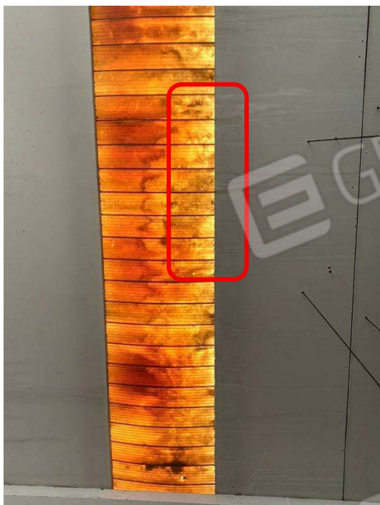
AREA D'INFILTRAZIONE* AL VERIFICARSI DI PIOGGE ABBONDANTI
