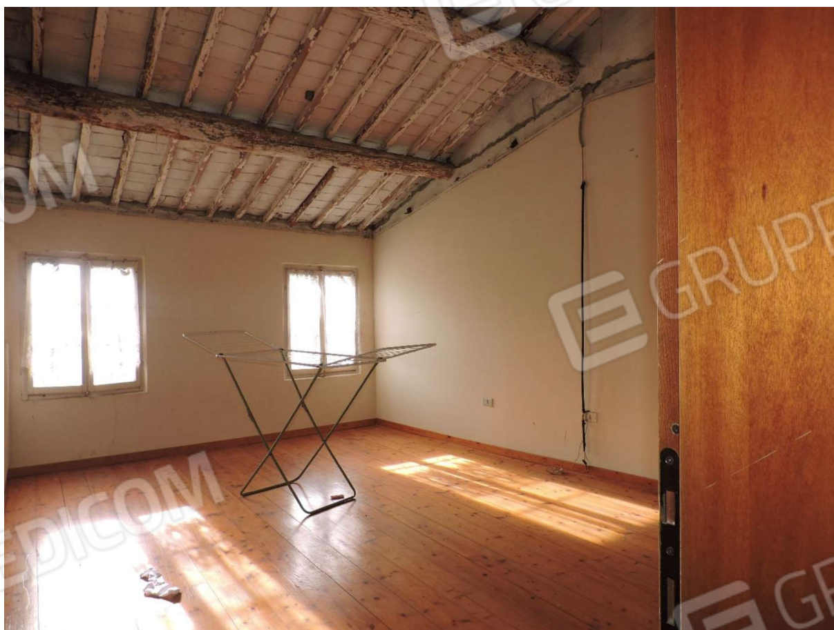
Foto -18 Vano piano 1° utilizzato dagli occupanti- data scatto 27.01.2026
