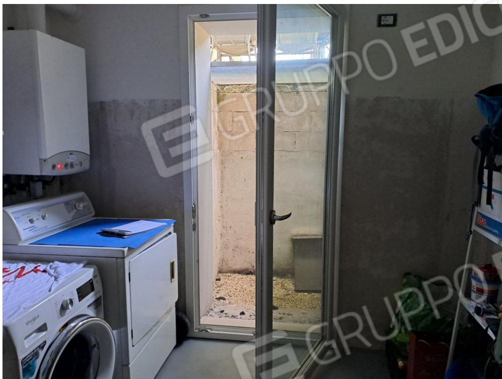
Vista della centrale termica / lavanderia
