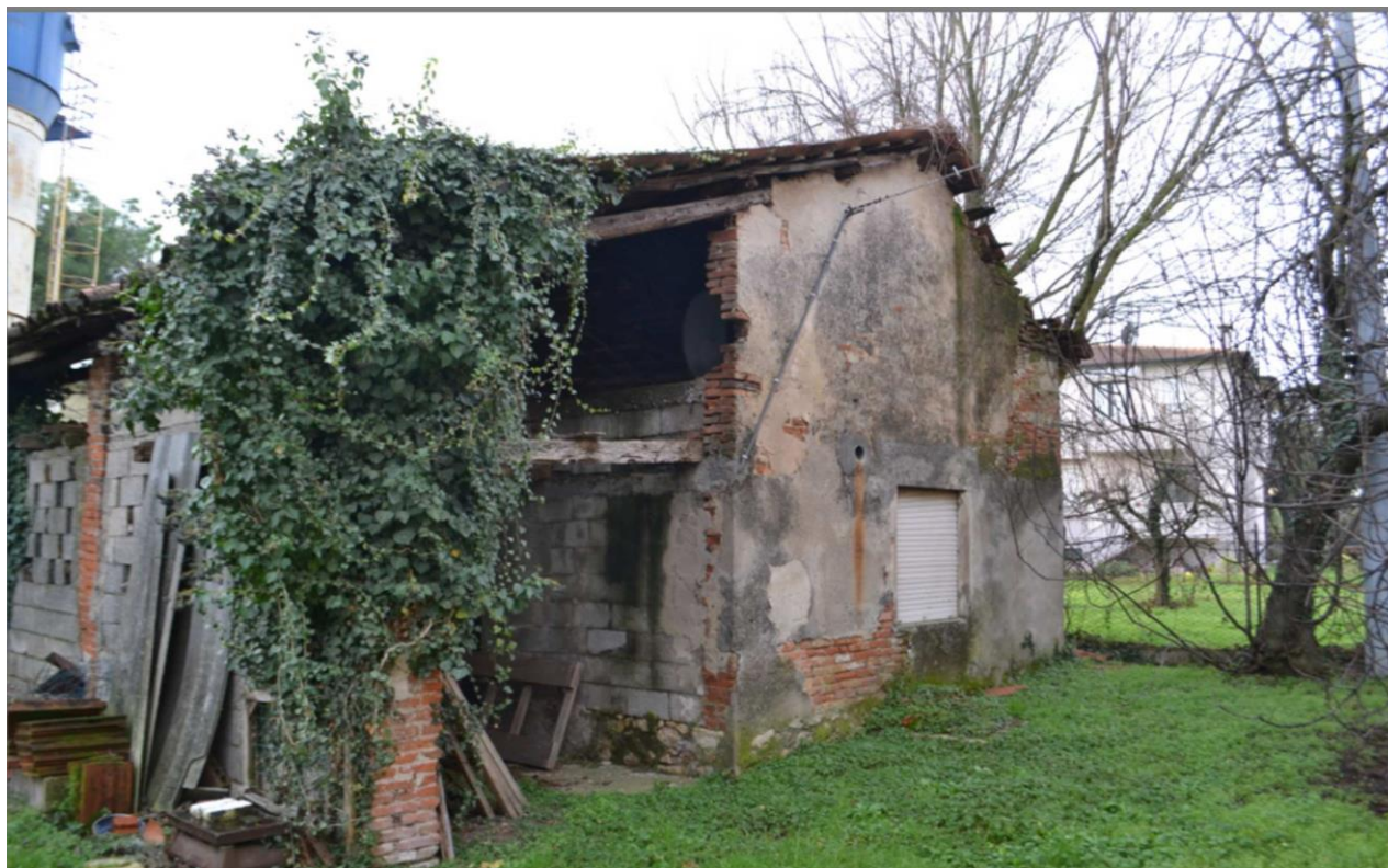
Figura 21- DETTAGLIO ESTERNO IMMOBILE DIRUO FG.19 PART.28; Corpo L) ABITAZIONE ECONOMICA- Trattasi di abitazione monofamiliare in stato di rudere.
