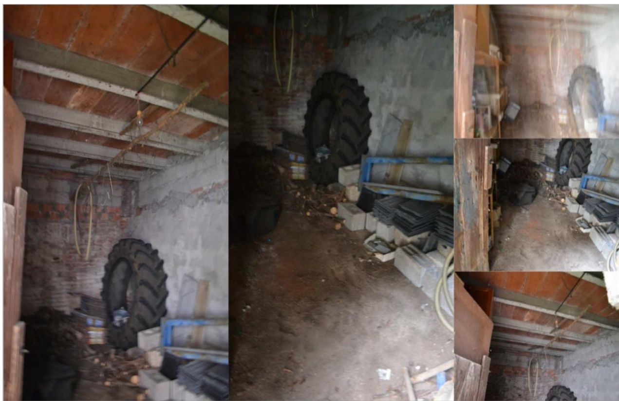
Figura 16-17-18-19-20- DETTAGLIO INTERNO IMMOBILE DIRUTO FG.19 PART.28;
