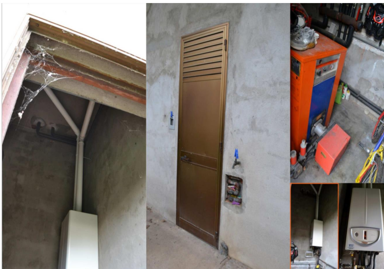
Figure 64-65-66-67-Vano caldaia ubicato al piano terra.
