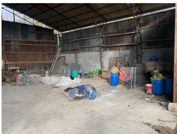
Deposito (parte abusiva da demolire).
