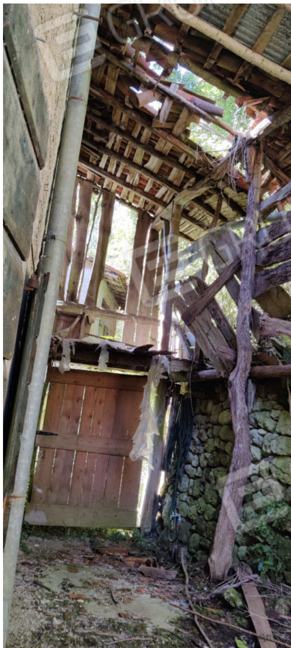
Foto n° 13 – Vista del portico e del ripostiglio insistenti sulla strada pubblica
