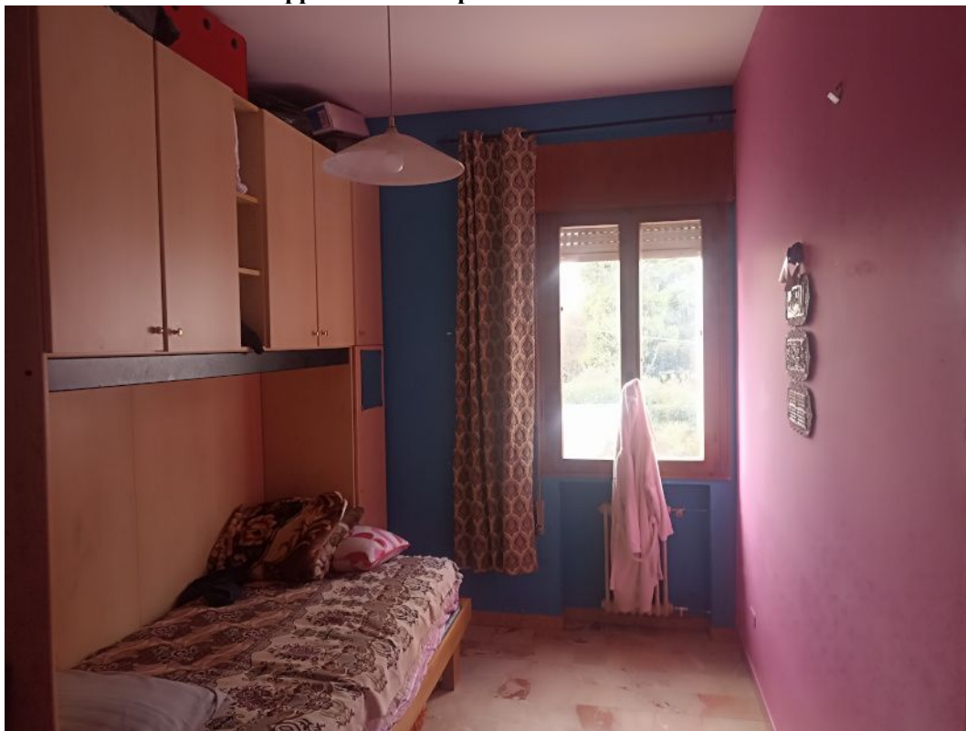
Foto 8 – infiltrazione dall'appartamento superiore che risulta risolta
