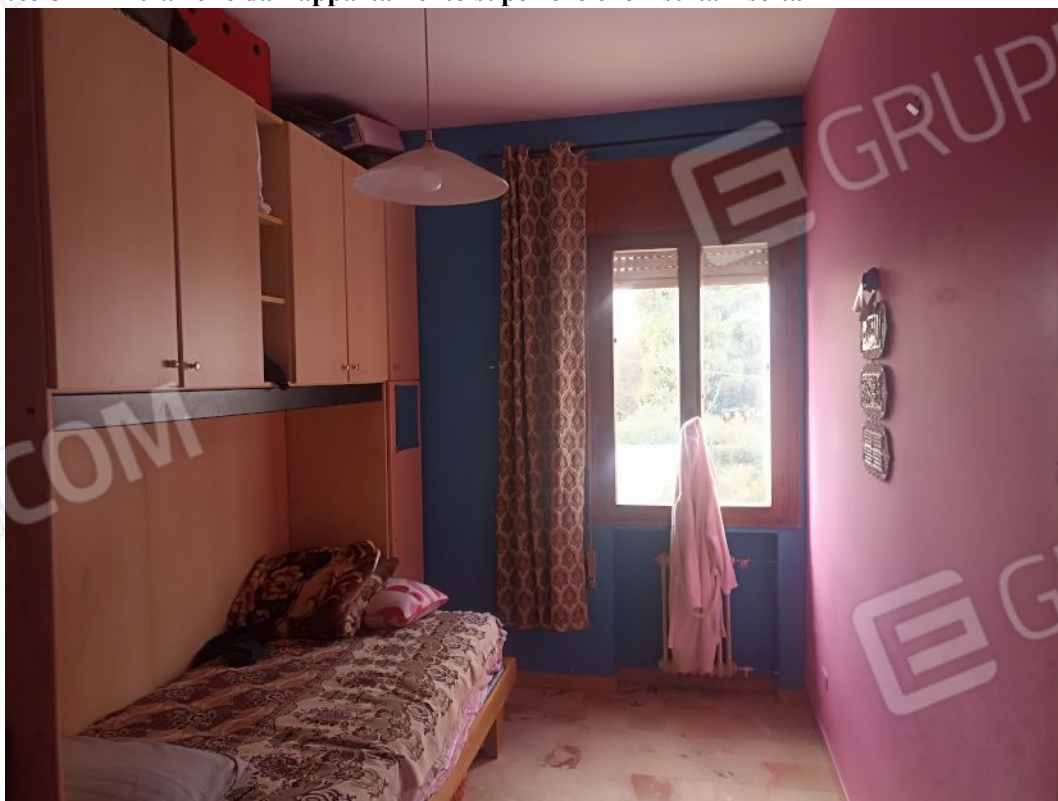
Foto 8 – infiltrazione dall'appartamento superiore che risulta risolta
