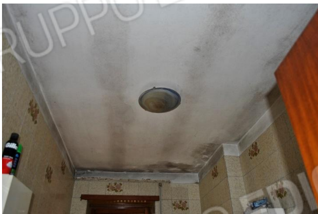
Foto 26 – bagno P.3 - soffitto
