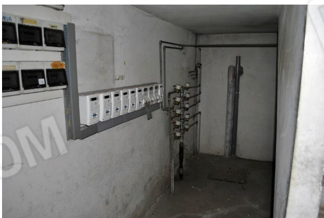
Foto 33 – vano tecnico contatori – P.ST
