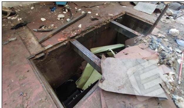
Vasche interrate piena di rifiuti speciali
