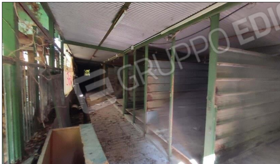
Canile lato est con strutture precarie
