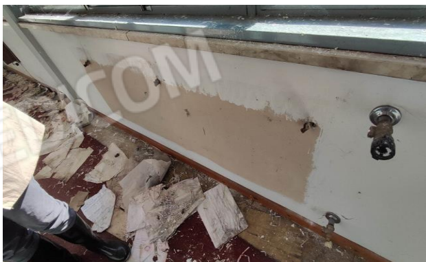
Uffici piano primo - ventilconvettori asportati
