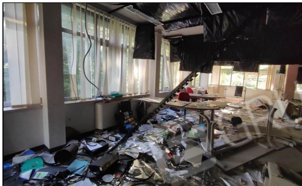
Uffici piano primo - controsoffitti asportati
