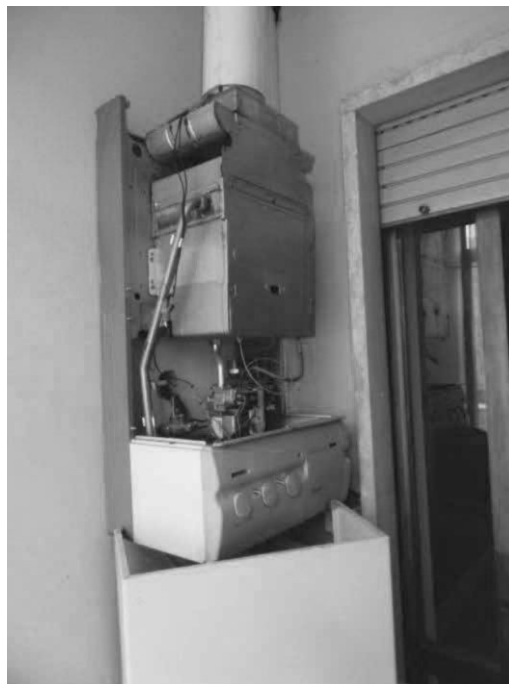
caldaia (posizionata nella loggia)
