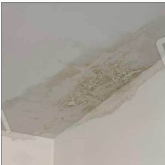
FOTO 14 - Infiltrazioni dal coperto
