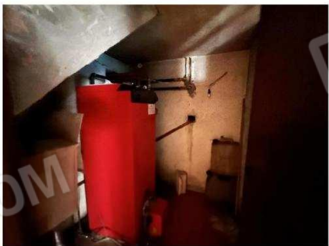
Vista della CT
