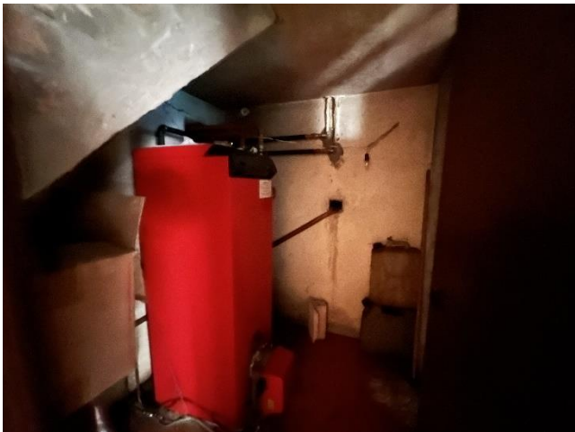
Vista della CT
