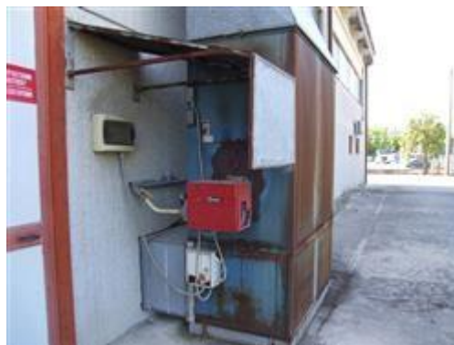
Posizione caldaia esterna
