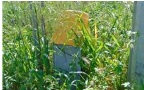
Vista particolare_Cassetta Contatore Elettrico
