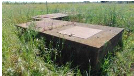
Veduta pozzetti acquedotto all'interno della p.lla n. 231
