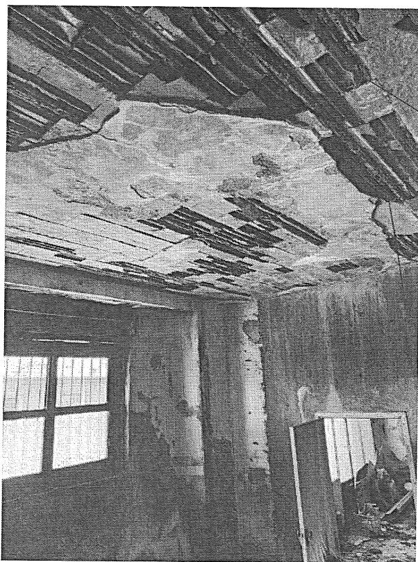
Foto 18 – Immobile Lotto “B” – particolare dei soffitti in evidente stato di degrado
