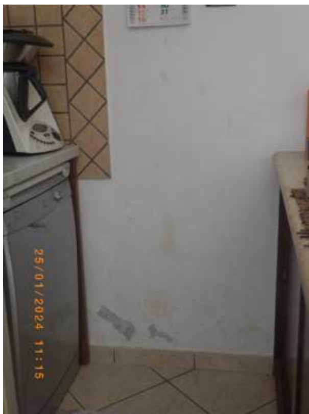
Foto 16. Paricolare_Cucina (umidità di risalita)
