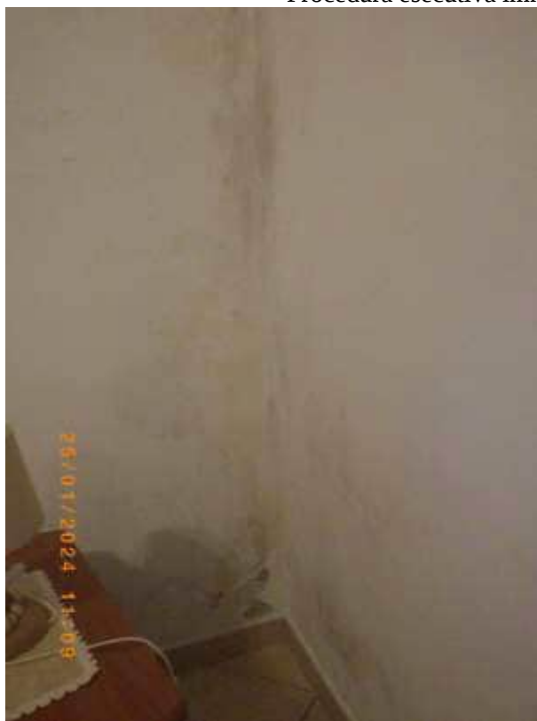
Foto 10. Particolare umidità spigolo Camera da letto matrimoniale
