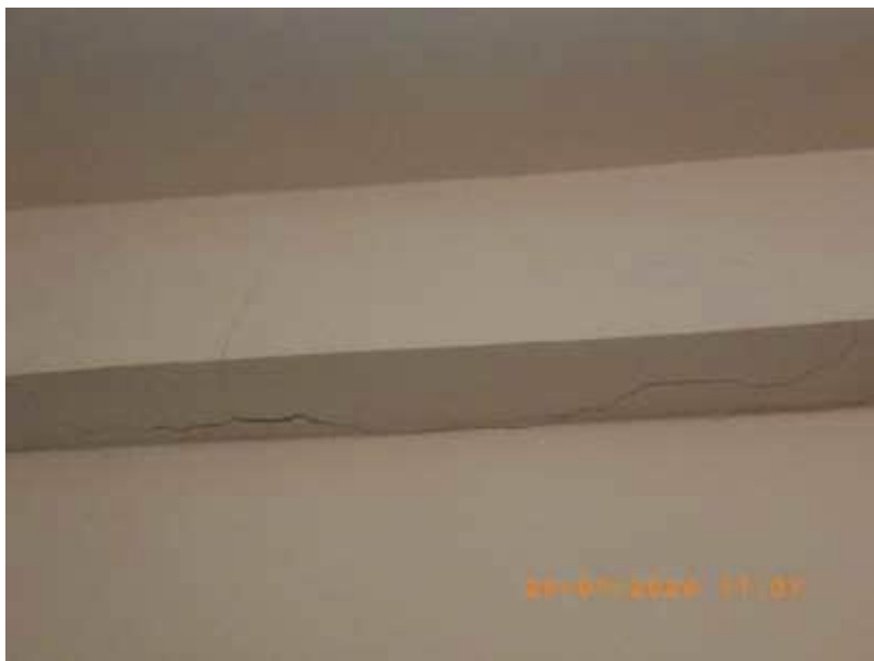
Foto 5. Particolare lesione trave Camera da letto singola
