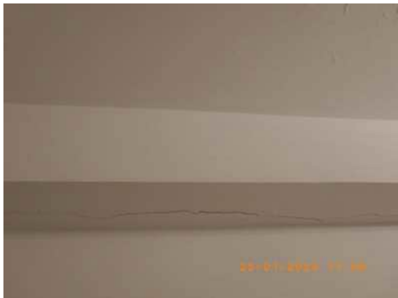
Foto 2. Particolare lesione trave bagno 1
