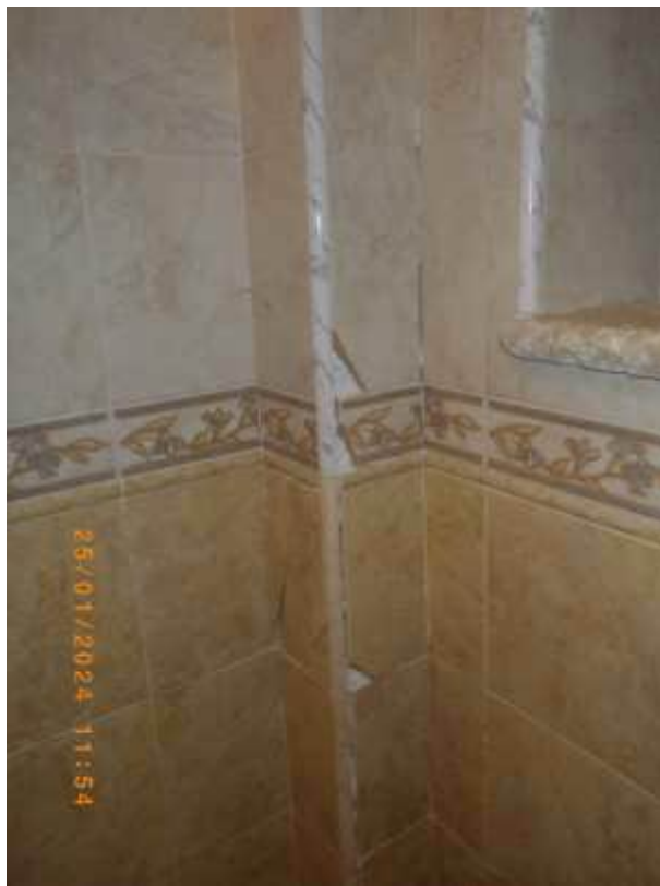
Foto 3. Particolare lesione bagno
