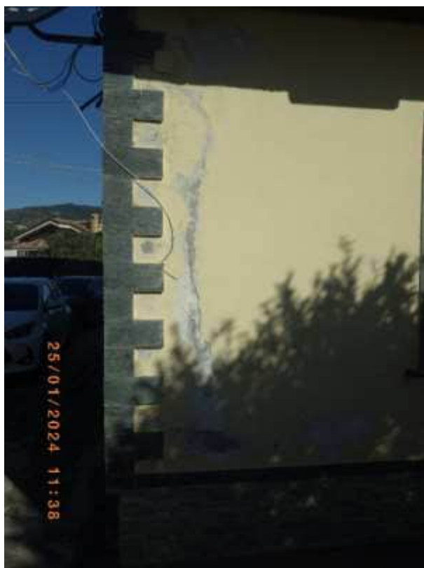
Foto 22. Particolarre lesione su parete esterna
